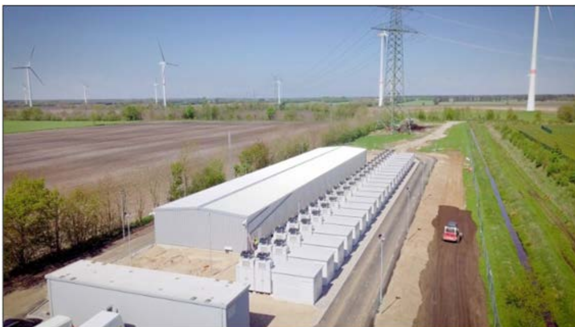
Figuur 2.14 Voorbeeld van batterijopslag in loods [bron: EnspireMe]
